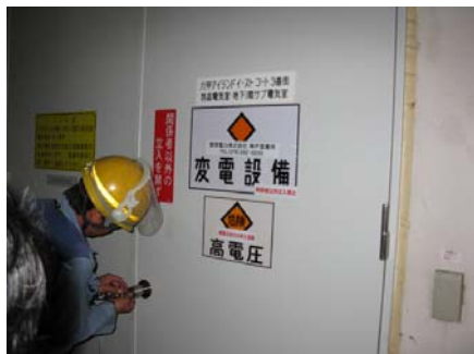
地下の特別高圧室
