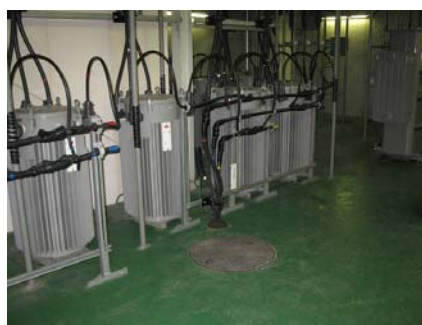
家庭用 変電トランス
