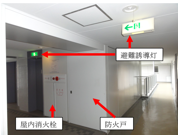
<エレベーターホールの防火戸>
